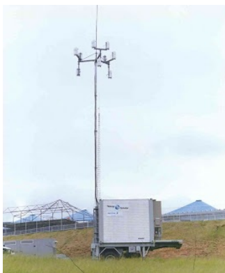
Figura 14 - Estação Rádio-Base móvel (cow) muito utilizada em eventos
